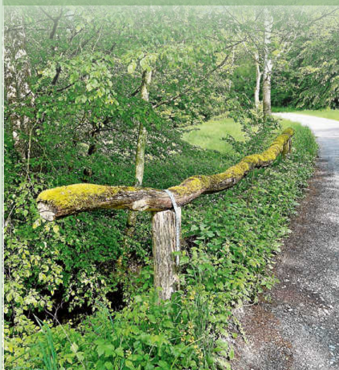
Zum Vergleich: So sah das Brückengeländer vor der Erneuerung in ähnlicher Form aus
