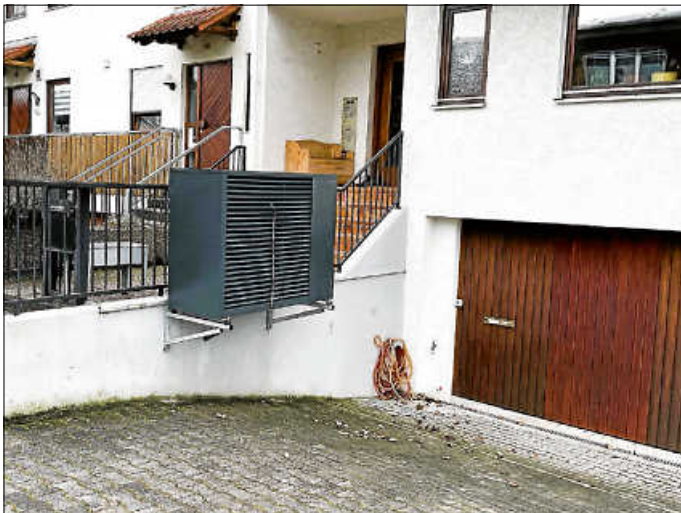
Wärmepumpen und der Anschluss an Fernwärmenetze bleiben auch zukünftig die sinnvollste Art zu heizen
